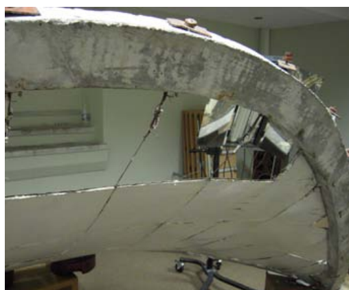
Ill 15. Tugevalt kahjustunud vineertahvlid asendati uutega.
