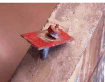
Ill 11. Kahjustunud metalldetail enne konserveerimist.
