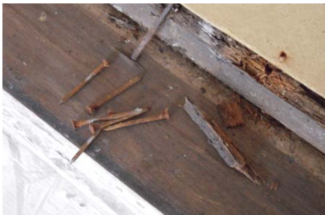
Ill 4. Okaspuidu seisund oli üldiselt hea, kuid puidu kinnitusrakid olid tugevalt roostes ja raami konstruktsioon nõrgenenud.
