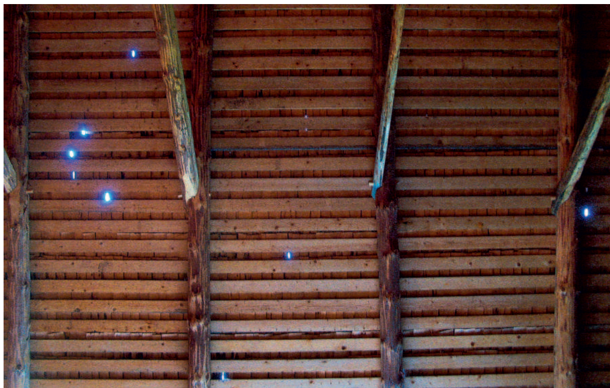
Esimised valguskiired läbi katusekatte annavad märku selle kohendamise vajadusest. Foto: Marko Teder.
