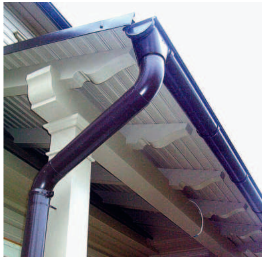
Ripprenn ja vihmaveetoru. Foto: Kalvi Kondio.
