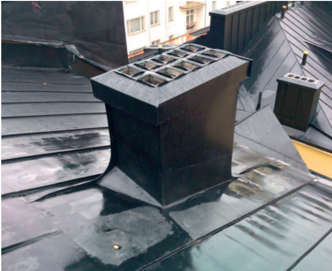
Sadulaga varustatud ventilatsioonikorsten. Foto: Kalvi Kondio.
