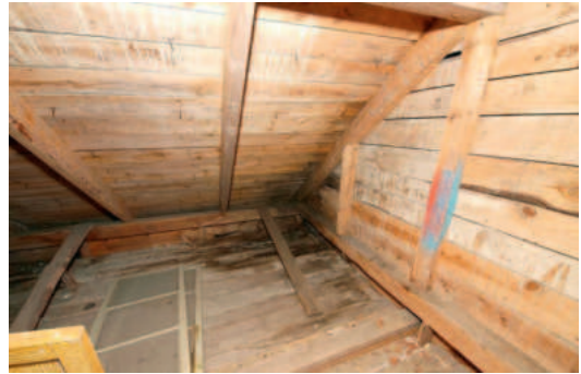
Kahjustunud räästasõlm hoone katusealuses. Foto: Marko Teder.
