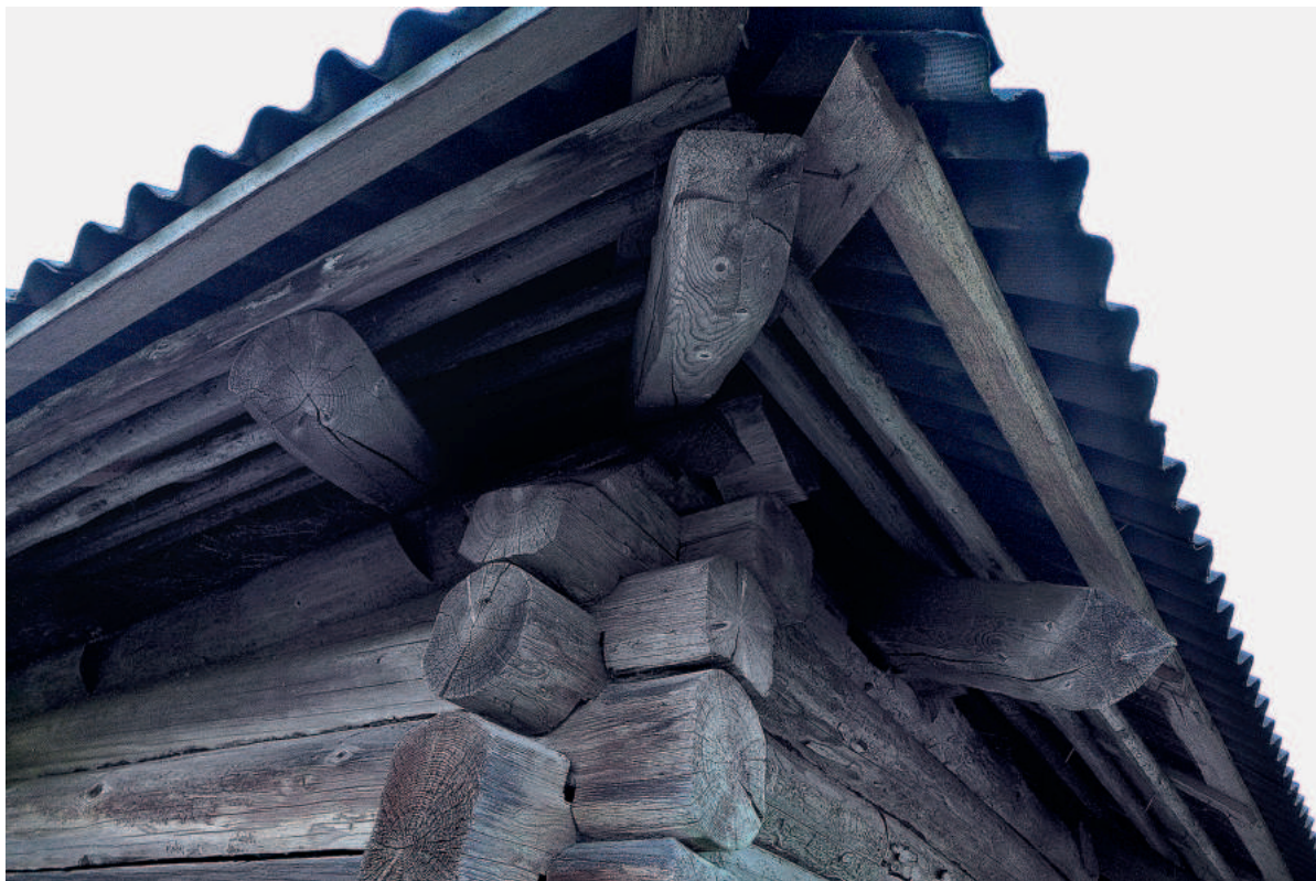
Kolme roodsarikaga rood. Kanepi valla Hinni talu rehemajal on rehealuse osas vähem kui meetrise vahega kolm roodsarikat: üks küljel, üks kelbal ja üks roodul. Ilmselgelt on tegu väga tugeva katusenurgaga. Hoone vajumishädade tõttu on näha murispuu tapid. Foto Joosep Metslang.
