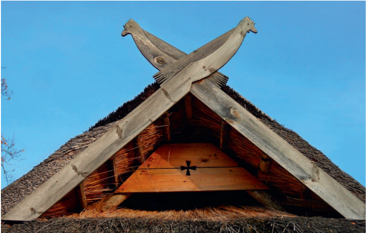
Unkaaugud, unkalauad ja kilbid Sass-Jaani talu katusel. Foto: Heiki Pärdi.
