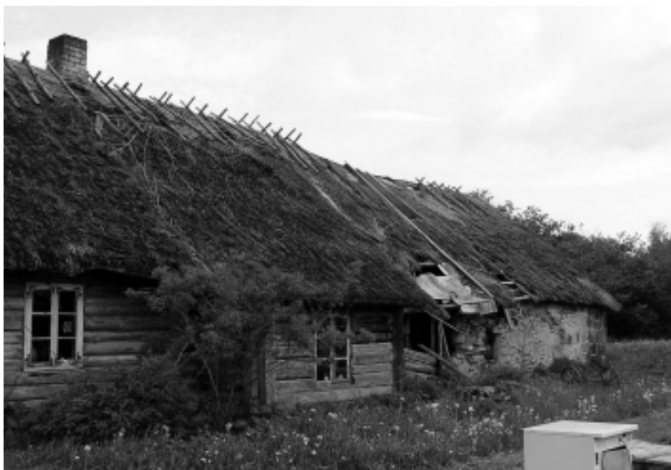
Rehealuse seinad on varisenud, hoone üldseisundit võib seega lugeda halvaks. EL
