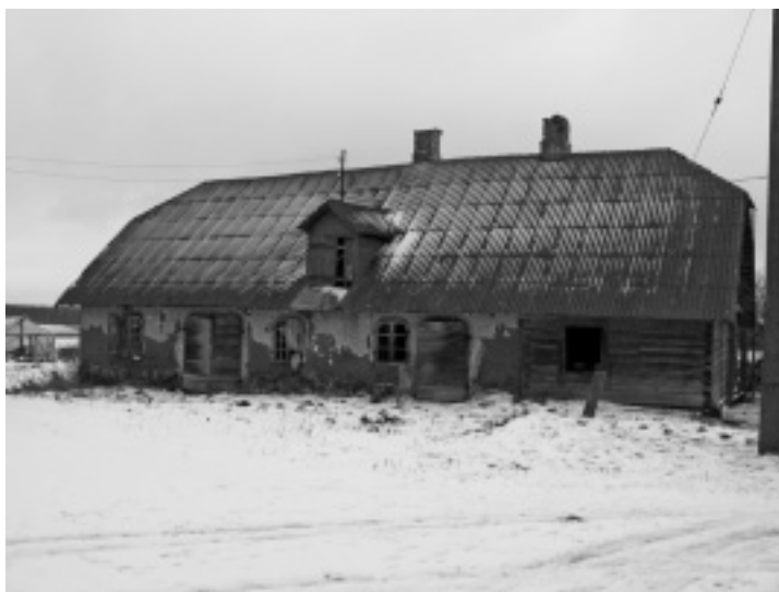
Savist laut Tartumaal. Rahuldavas olukorras hoonel on madal graniidist sokkel ja eterniidiga kaetud poolkelpkatus. Üks hoone tiib on valmistatud tahatud palkidest ja puhasnurkadega. JM
