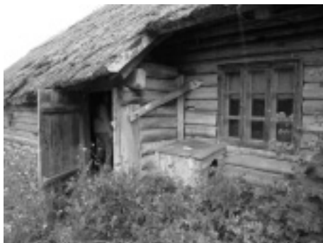
Rehemaja tuulekoda on rehetoaga kinnitatud puidust tõmmitsaga, kasutatud on nurgaposti. Rehetoal on avar aken: üks raam ja üheksa ruutu. Ulalusesse on paigutatud lihtne koerakuut. JM
