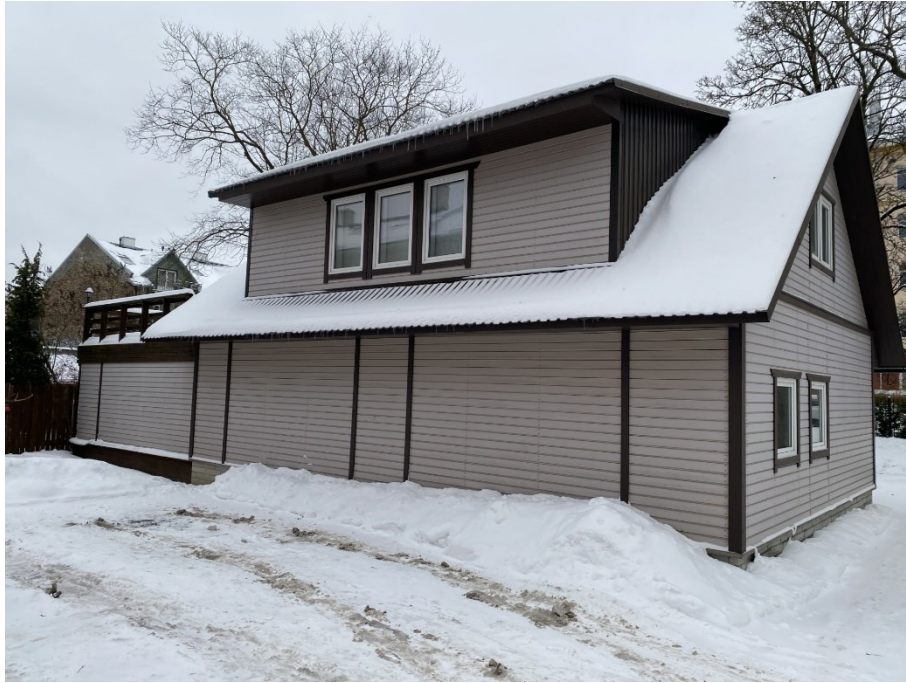
Joonis 13 Hoone põhjapoolisel küljel on lahendamata vihmaveesüsteem. Sokkel on pidevas kontaktis lumehangega ja sula korral imbub vesi vundamendi ümbrusse. Suvel langeb vihmavesi katuselt otse sokli äärde maapinnale ja tuule mõjul ka fassaadile.
