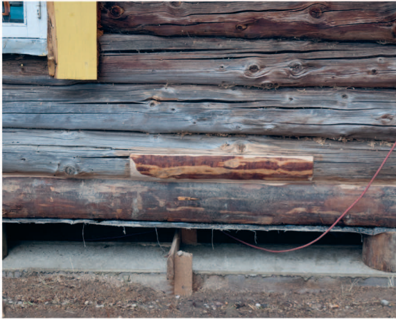
Kivistunud taldmikule saab hoone uuesti toetada ja jätkata taldmiku valamistöödega järgmises lõigus.
