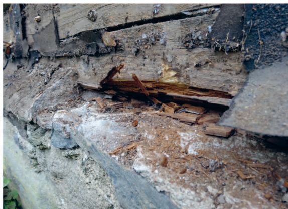
Vastu alumist palki paigaldatud mördi ja hüdroisolatsiooni puudumise tõttu on alumine palk pehkinud.
