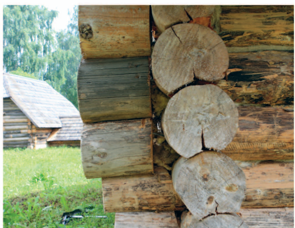
Palkide vahetamisel on rikutud korralike palkide pähikud, kohati on lisatud pähikuimitatsioone, mis on kinnitatud naelaga.
