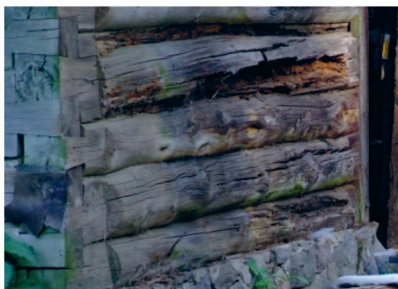
Niiskuskahjustusega otsasein. Vihmavesi on sattunud kuivamislohedesse ja mädananud palgid.
