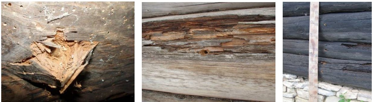
Joonis 4.7 Pruunmädanikuga kahjustatud konstruktsioonid: põrandatala (vaskul), seinapalk 1m kõrgusel (keskel), kolm esimest seinapalki (paremal).
