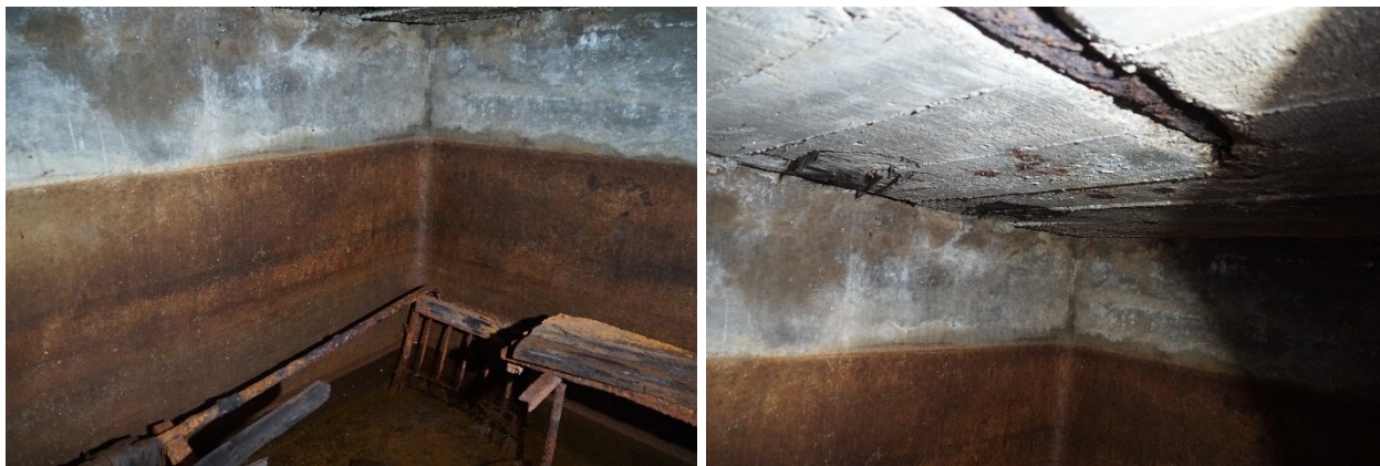
Joonis 3 Raudbetoonist kelder palkmaja esiku all. Keldri põrandal oli suve lõpus umbes 20 cm vett ja kõrgvee piir keldri seinal on lähedane maapinna tasapinnaga väljas (vasakul). Paremal on näha korrodeerunud metallkanduritel läbivajunud betoonist keldrilagi.
