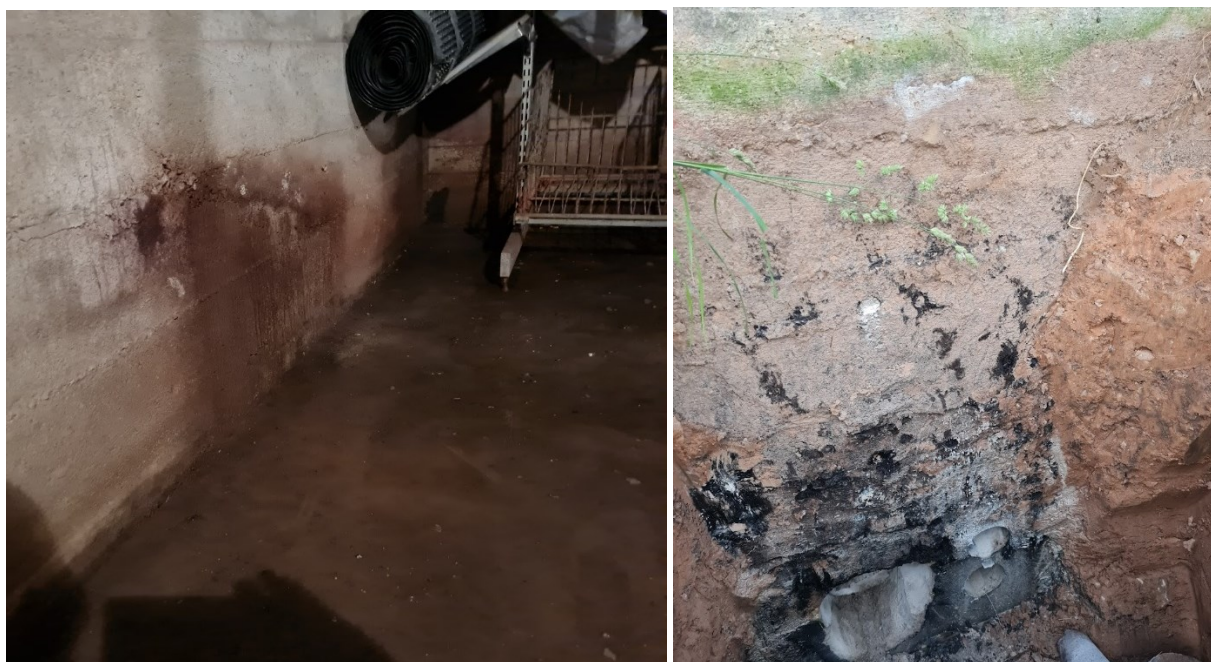
Joonis 1 1970. aastatel rajatud betoonseinte ja -põrandaga kelder. Sügisel ja kevadel on keldri põrandal vesi ning seintel on näha hõredama betooniga kohad, kust vesi läbi seina keldrisse tungib. Sama keldri betoonseina väljastpoolt lahti kaevates selgus, et hüdroisolatsioon oli küll tehtud, kuid tõrvapapp oli aja jooksul lagunenud. Allpool oli ilmselt kasutatud lisaks tõrvapapile ka vööpa, kuid ka see kiht oli katkestustega.
