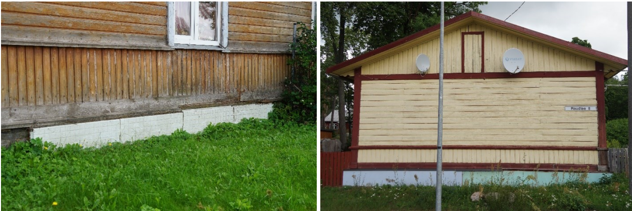
Joonis 2 Osaline lisasoojustus ei vähenda oluliselt soojuskadu ja tööd on jäetud lõpetamata (vasakul). Puihoone sokkel on soojustatud vahtpolüstüreenplaatidega, kuid jäetud ilmastiku eest kaitsmata (paremal).
