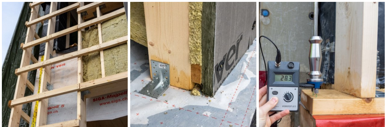
Joonis 5 Puit, aurutõkkemembraan ja tuuletõkkeplaat on niiskustundlikud materjalid ning nende paigaldus ilma ilmastikukaitseta on halb lahendus (vasakul). Lisaks pole soojustus paigaldatud kvaliteetselt – soojustusmaterjal ei tohi olla volditud karkassipostide vahele – nii tekivad õhukanalid, kus hakkab õhk liikuma ja soojustuskihi tõhusus väheneb. Niiskustundlikke materjale ei tohi paigaldada veelompi (keskel). Sademetele avatult ehitades tõuseb puitkarkassi niiskus sisaldus üle lubatud piirmäära (paremal). Fotod: Kristo Kalbe.
