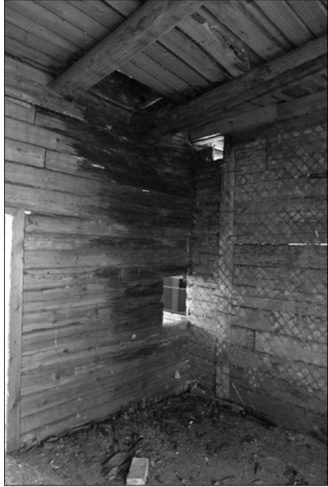
Seenkahjustused II korruse ruumis 29.
