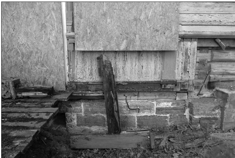
Vanema hoonekehandi paekivivundament, paremal on näha peamiselt kuusepalkide ümar välisosa. Fotod ja skeemid selles artiklis: J. Metslang
