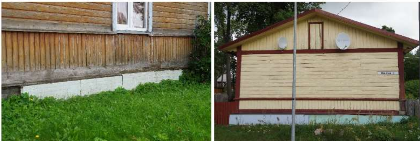
Joonis 2 Osaline lisasoojustus ei vähenda oluliselt soojuskadu ja tööd on jäetud lõpetamata (vasakul). Puithoone sokkel on soojustatud vahtpolüstüreenplaatidega, kuid jäetud ilmastiku eest kaitsmata (paremal).
