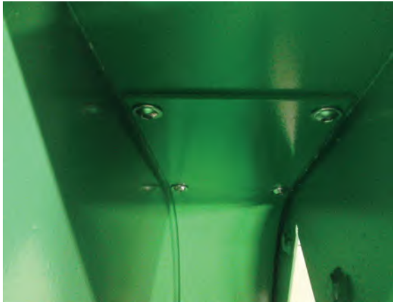
Hardox-Verschleißschutz im Turbinengehäuse
