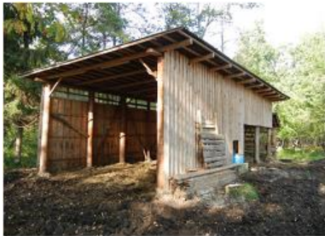
Maapind on kahjustatud kariloomade tõttu.
