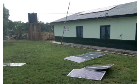
Heruntergerissene Solarmodule des Huttel Health Centers
