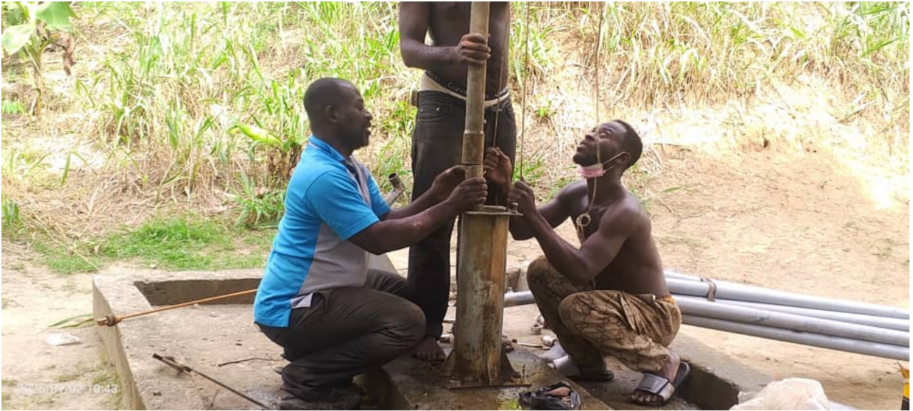
Inspektion eines fehlerhaften Brunnens durch die Fachleute vor Ort.
