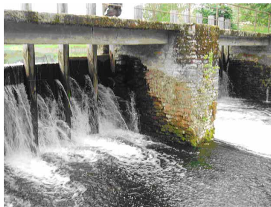
Foto 2. Kaldasamba kahjustused (pildi autor Rain Elken)
