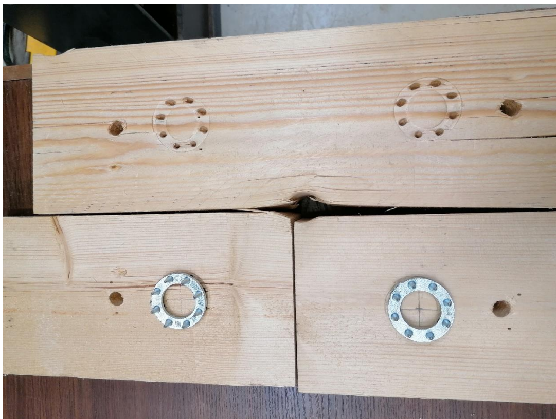
L5.4. Katsekeha JT4-C10 hammastüübli ja puidu muljumine.
