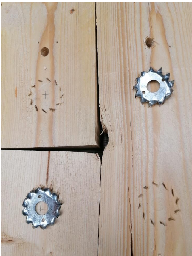
L4.7. Katsekeha JT7-C1 hammastüübli ja puidu muljumine.
