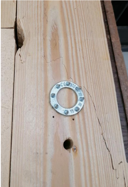
Joonis 3.20. C10/50 hammastüübliga jätkatud tala paindekatsel koormusest tekkinud mõra puidu sees ning tugede muljumisjälg.
