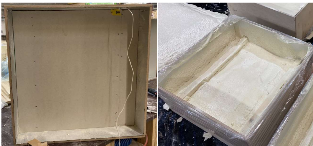
Joonis 3.32 Vasakpoolsel pildil näha vahed kipsplaadi servades ja parempoolsel ebaühtlane PUR vahu kiht sisemise roovi juures
