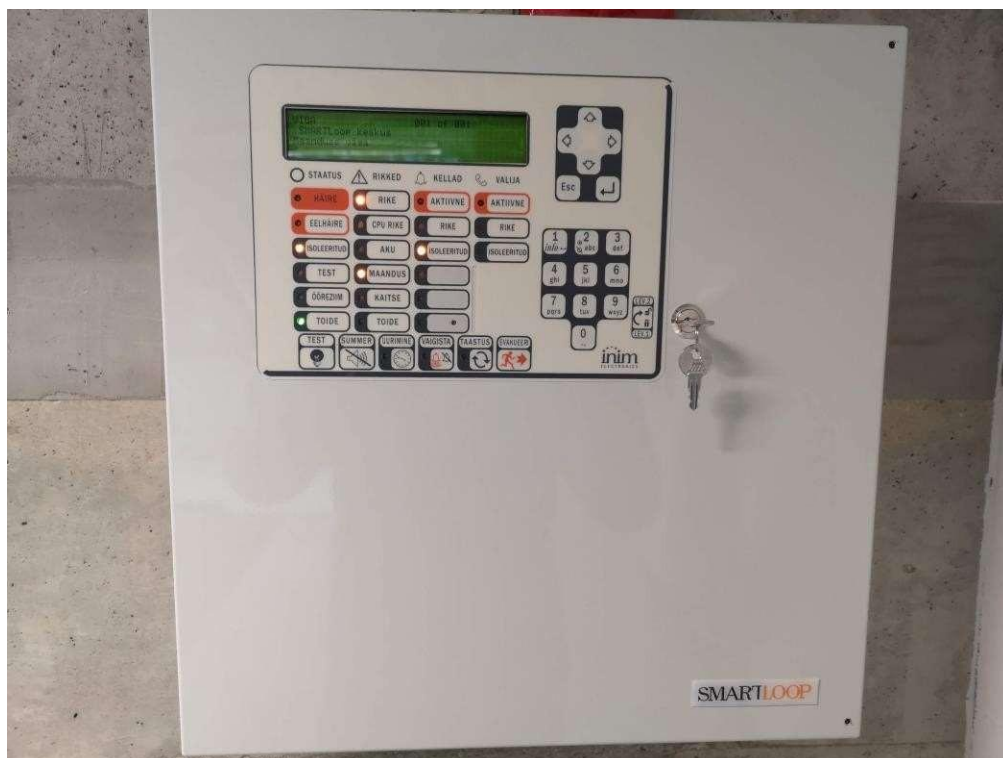
Foto. Kõrveküla Põhikooli ATS keskseade.
