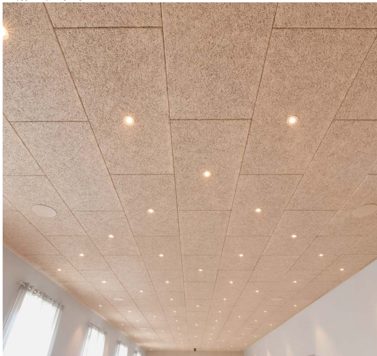
Indbygget belysning i tag
