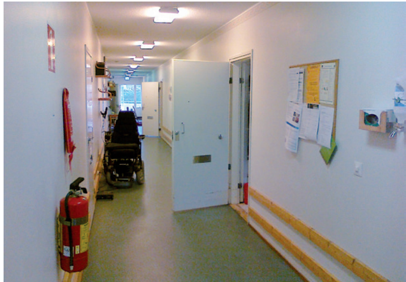
Kuva 5: Hoitolaitoksissa ja palvelu- ja tukiasuntokohteissa palo-ovia saateen pitää avoinna valvonnan helpottamiseksi, mikä edesauttaa palon ja savunleviämistä palotilanteessa.
