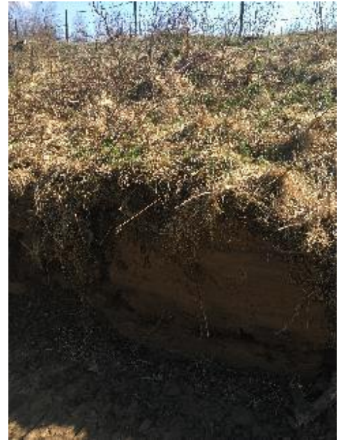
Рисунок 35. Ознаки порушення цілісності обвалування амбару № 1 ЦППН, квітень 2019
