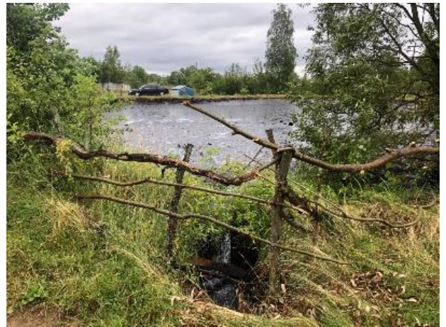
Рисунок 42. Порушення огороження та обвалування амбару № 2 ГТУ-3
