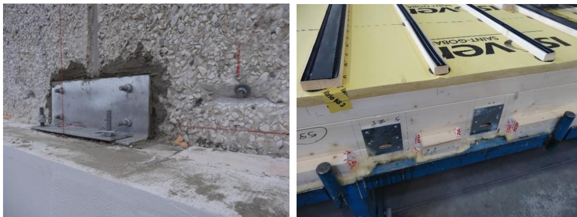
Joonis 28. Vasakul fotol on kinnituskronstein ja olemasoleva raudbetoonkooriku ankur ning paremal fotol sein lisasoojustuselementide metallplaadiga tugevdatud toetuspunktid.
