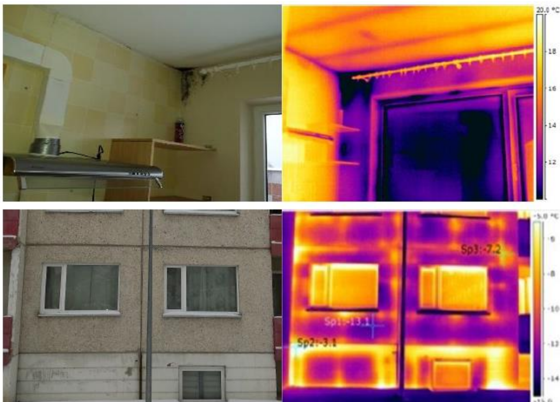
Joonis 9. Ülemised fotod illustreerivad hallitust ning külmasilda lae ja välisseina kohtumiskohas. Alumistel fotodel on kujutatud seinapaneelide soojusläbivusi. (Kalamees et al. 2017)
