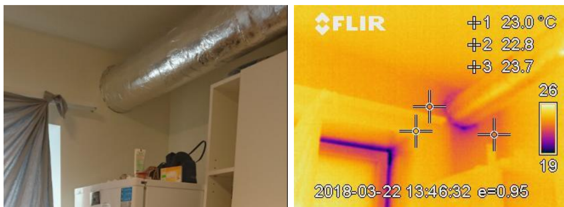
Joonis 49. Korter 14 - ventilatsiooni läbiviik läbi välisseina. Vasakul on foto reaaset olukorrast, paremal on pindade temperatuurid 50 Pa alarõhu juures (autori fotod).
